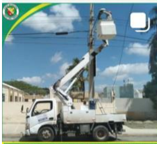
Operativo de cambio y reparación de lámparas en los sectores Valle Verde, carretera Sajama y Villa Tabascalera.
