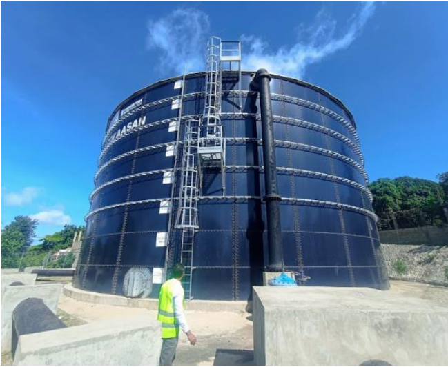
Tanque nuevo de Gurabo
