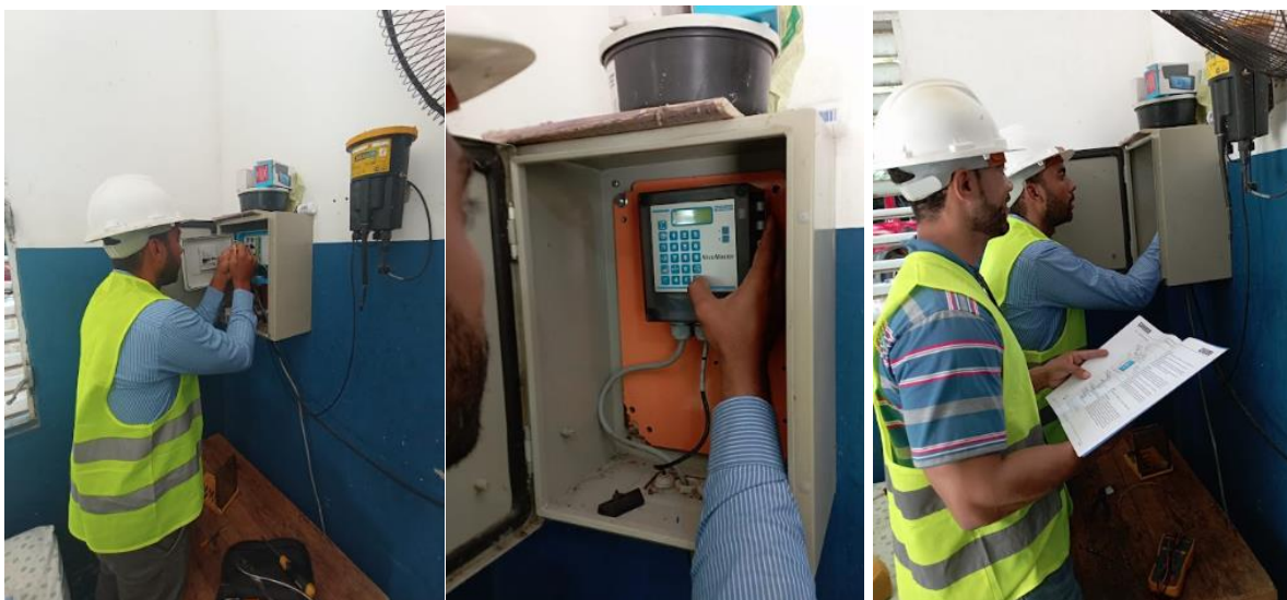
Instalación de sensores cerros de Gurabo
