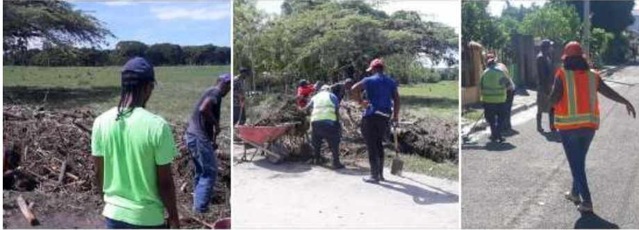
Limpieza de Escombros tras crecidas del Río Yásica y Venú tramo carretero El Remolino, La Piña 22 de Septiembre del año 2022.
