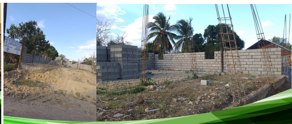
Con un aporte de nuestra institución se reiniciaron la construcción de la Iglesia Evangélica en la entrada de Arroyo Hondo.
