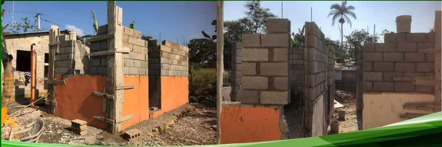
Reconstrucción de Casa afectada por incendio en la comunidad de Los Basora propiedad del Sr. Ángel Lantigua Basora.
