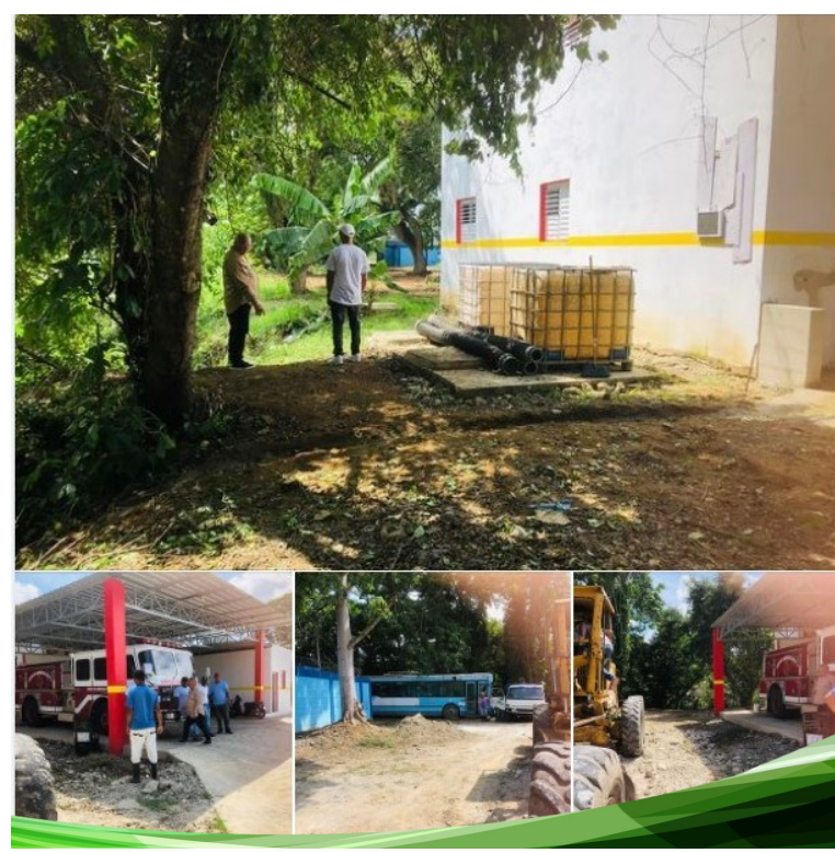
Nuestro Alcalde encabezando los trabajos de aseo y acondicionamiento del entorno de nuestro cuartel de Bombero para su Inauguración.
