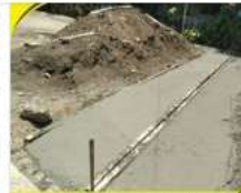
Continuación de la construcción del bache en la calle principal del sector Los Mayos, Hato del Yaque
