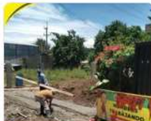
Continuación de la construcción del bache en la calle principal del sector Los Mayos, Hato del Yaque
