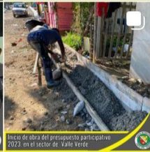
Inicio de obra del presupuesto participativo 2023 en el sector de Valle Verde
