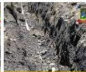
INICIAN TRABAJOS DE INSTALACION DE RED DE ABASTECIMIENTO DE AGUA EN CALLE DE LOS GUSTOS
