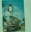
Operarios de bombas en toda el Distrito
