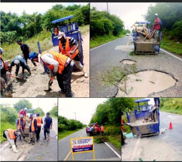
⚠️ Precaución en la carretera Quisqueya - SPM, nuestros hombres están tapando los hoyos. Ministerio de Obras Públicas y Comunicaciones - RD Gobernación SPM Aracelis Villanueva Figuera
