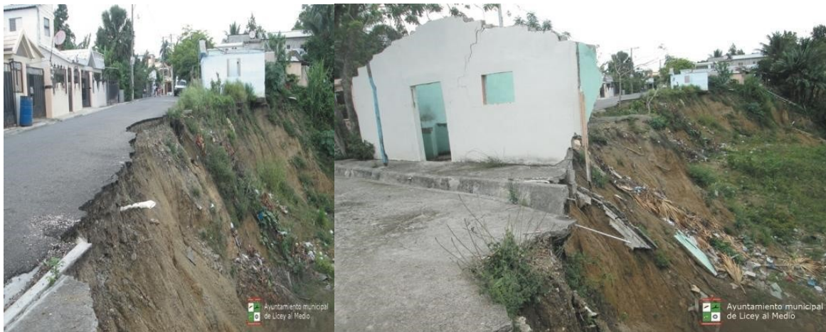
Las inundaciones y los deslizamientos han causado daño a la infraestructura vial y habitacional, por mal uso del suelo.
