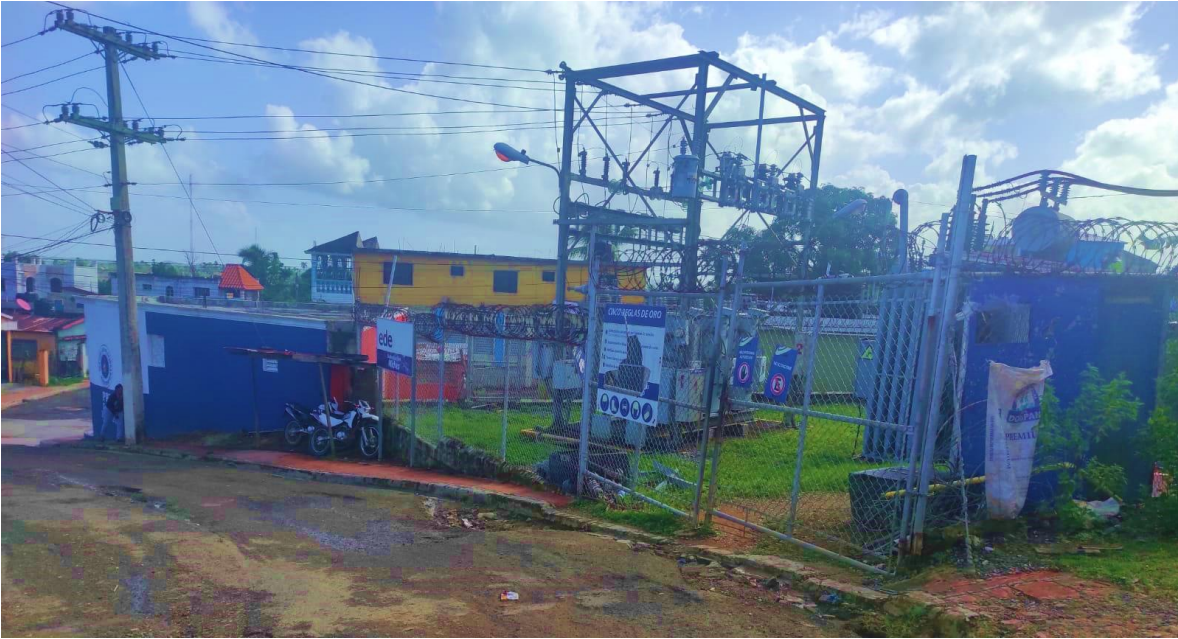
Subestación Eléctrica de Miches
