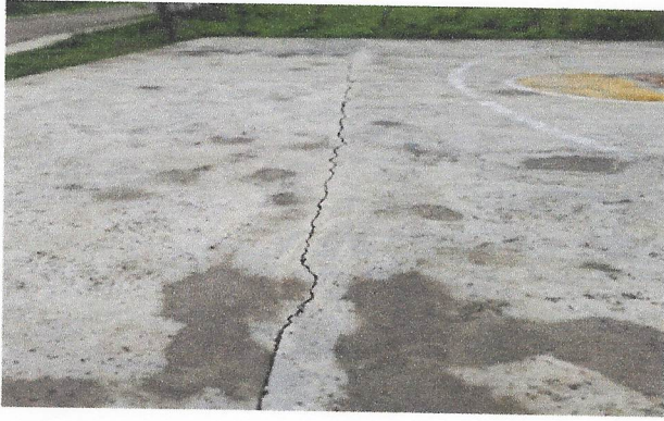
Grietas a reoarar por inyeccion
