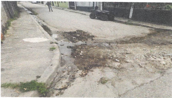
Badenes totalmente deteriorado
