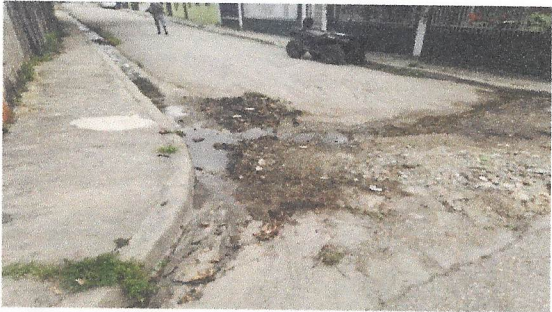
Badenes totalmente deteriorado
