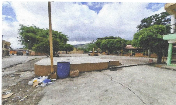
Grietas en pisos
