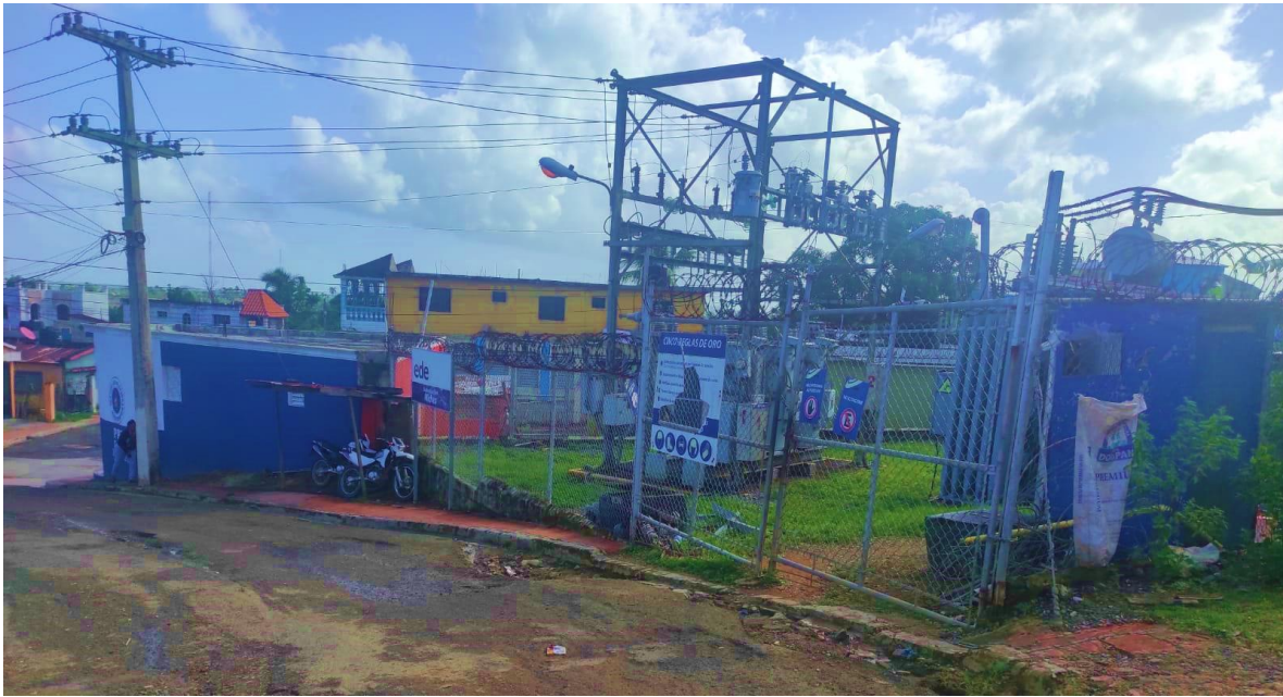
Subestación Eléctrica de Miches
