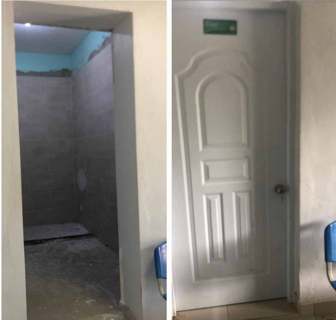
Colocación de Puerta de la Oficina de Redes Sociales, OAI y Relaciones Públicas
