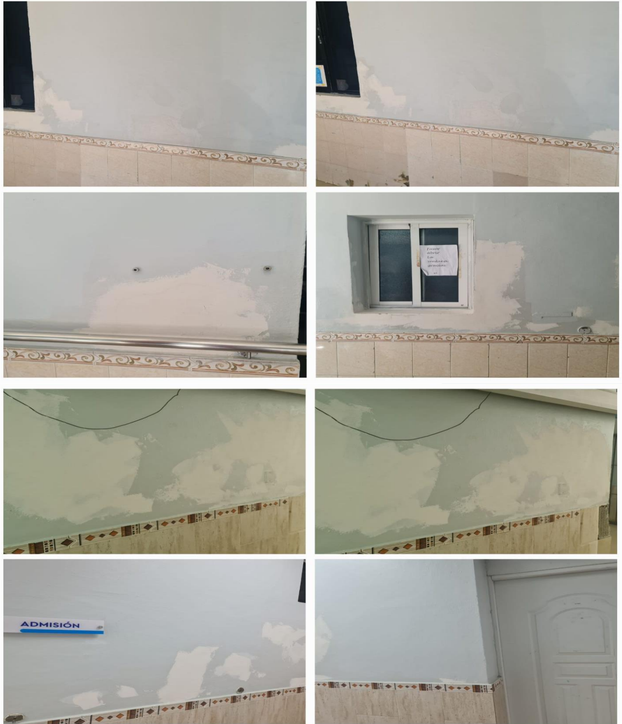
Pintura Paredes Pasillo Admisión (Antes)
