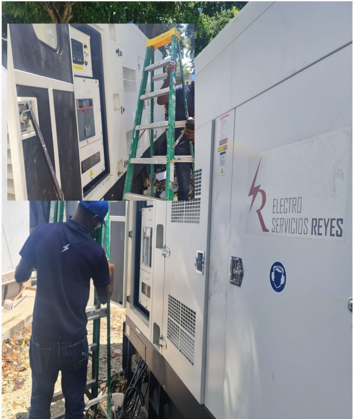
Mantenimiento Planta Eléctrica
