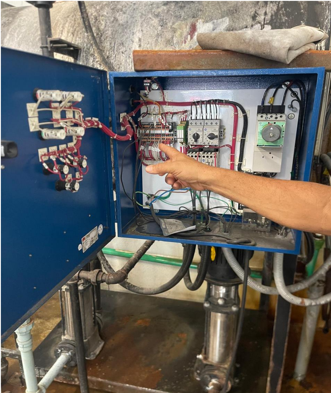
Mantenimiento al panel de control de la caldera y el tanque de vapor
