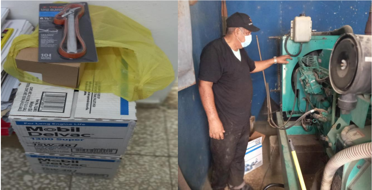
Cambio de aceite, filtro, culam y cable eléctrico de la planta eléctrica, en fecha 22/01/2024.
