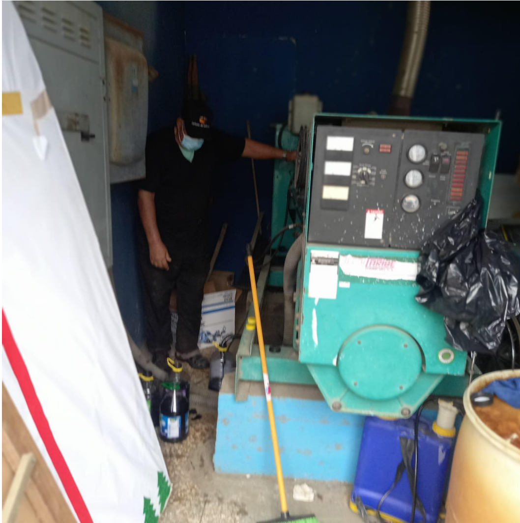
Cambio de aceite, filtro, culam y cable eléctrico de la planta eléctrica, en fecha 22/01/2024.
