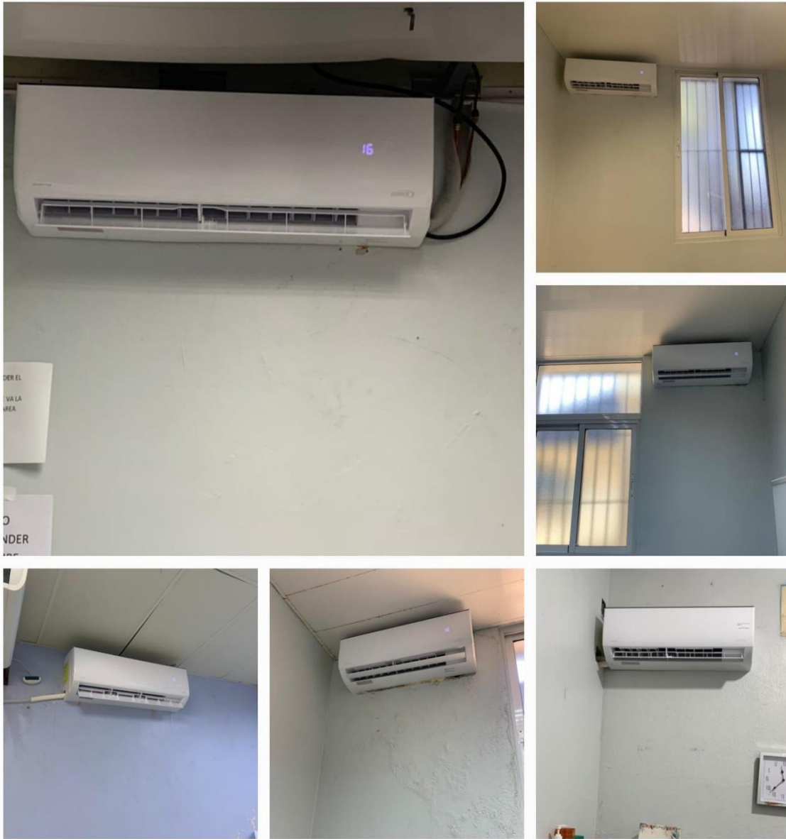
Colocacion en diferentes Areas de Aires Acondicionados
