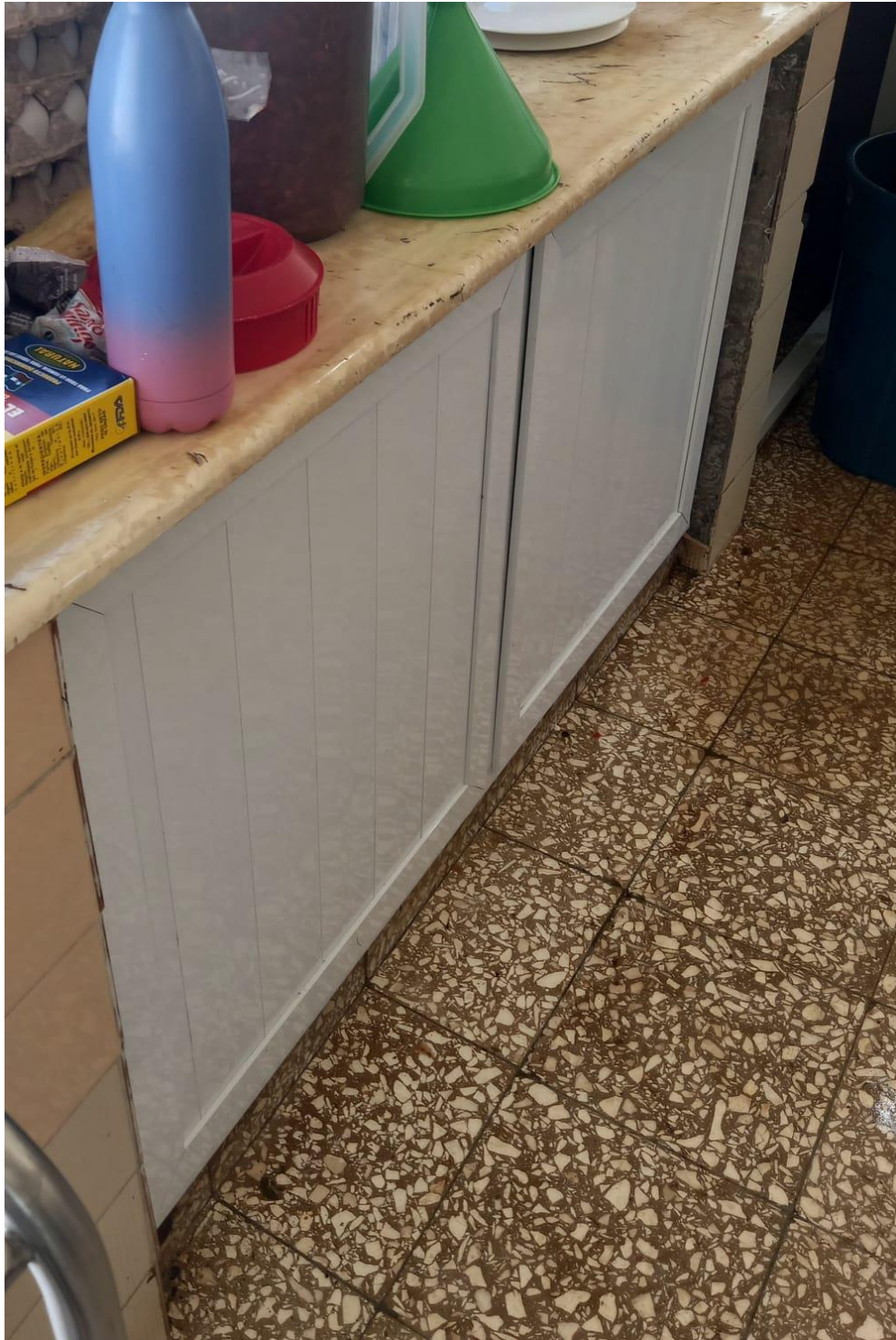
Postura de puerta de gabinete de la cocina en fecha 27/08/2024
