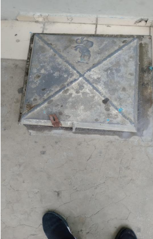
TAPA EN MAL ESTADO
