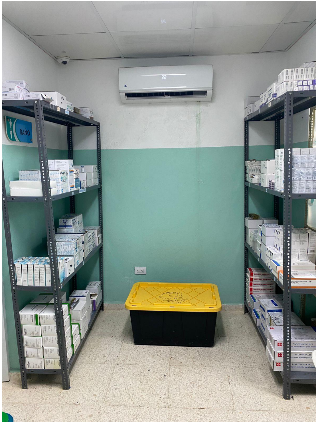
Ilustración 7. Farmacia centra organizada en forma de U para un mejor desplazamiento de los colaboradores. De igual manera se puede observar el aire que climatiza el área y que se cuenta con buena iluminación. También se puede evidenciar filtraciones en la pared donde se encuentra el aire acondicionado.
