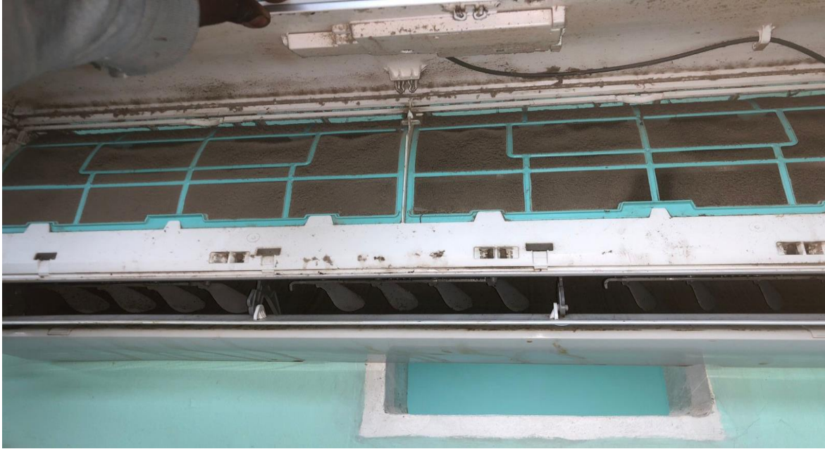
Aire piso techo
