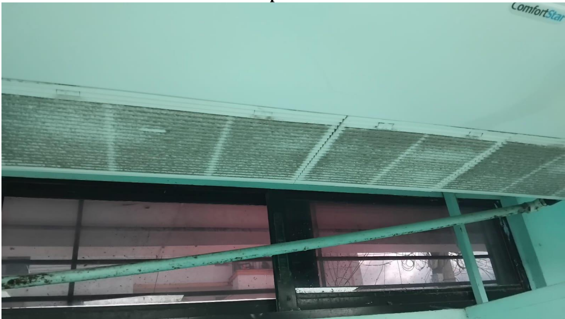
Aire piso techo
