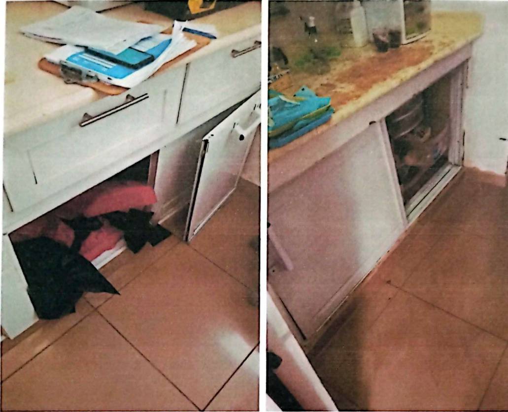
Gabinetes odontología con puertas despegadas
