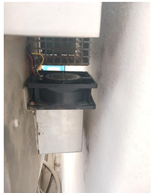
Ventilador nuevo instalado
