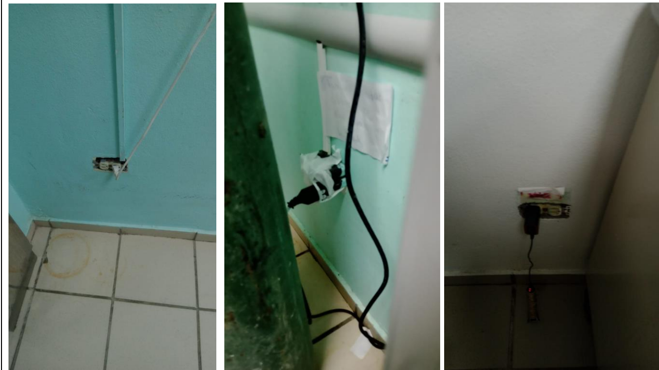
Toma corrientes es salas de internamiento.
