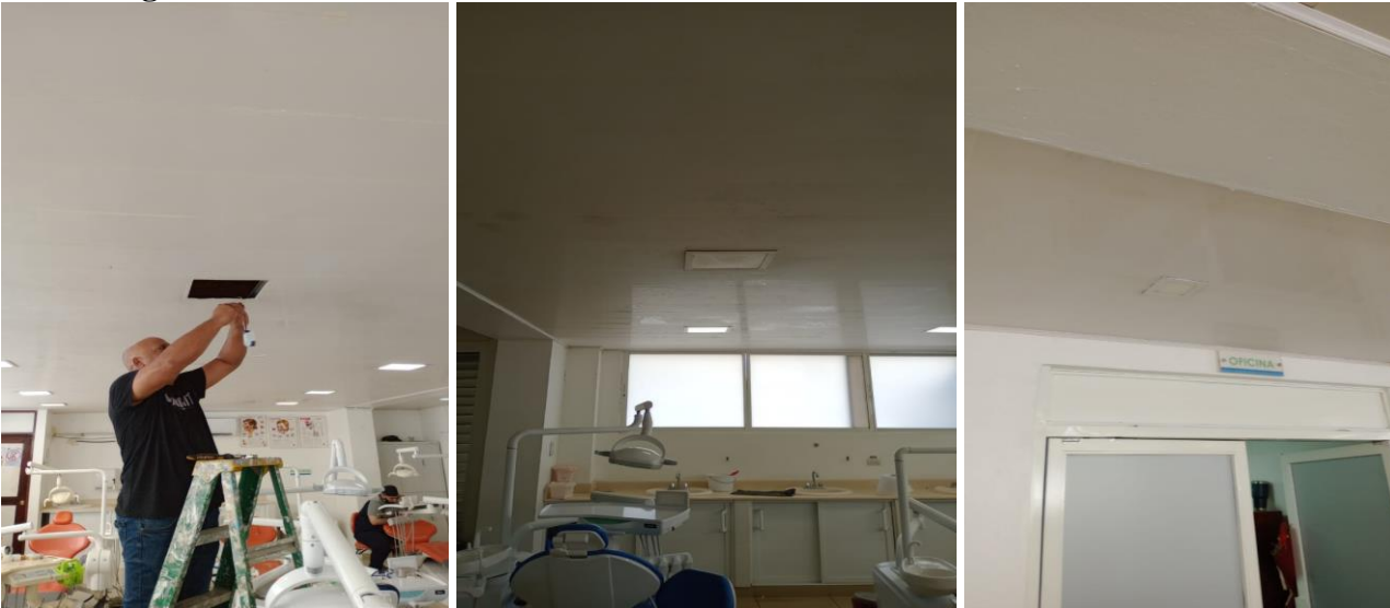
Aires acondicionados: Se realizó mantenimiento preventivo, limpieza de filtros y limpieza profunda con hidrolavadora a los siguientes aires:
