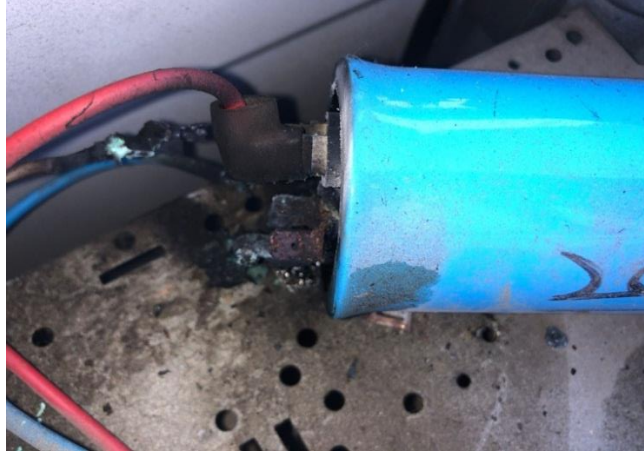
Aires acondicionado Primer nivel: Triage, consultorios 1,2,3,4,5,6 Psicología Sai
