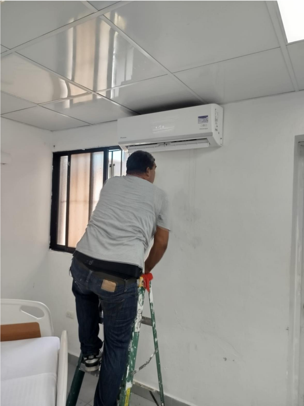
#2. Mantenimiento de filtros de Aires Acondicionados. Almirante Enero 2025
