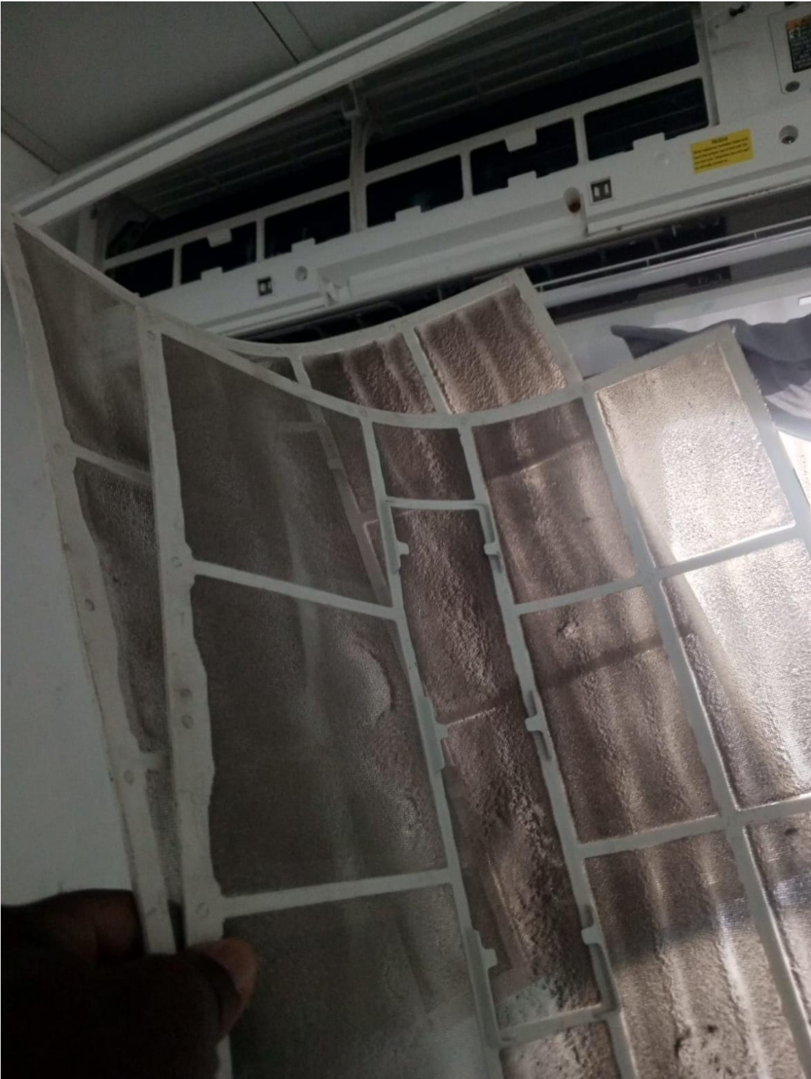
#1 .Mantenimiento de filtros de Aires Acondicionados. Almirante Enero 2025
