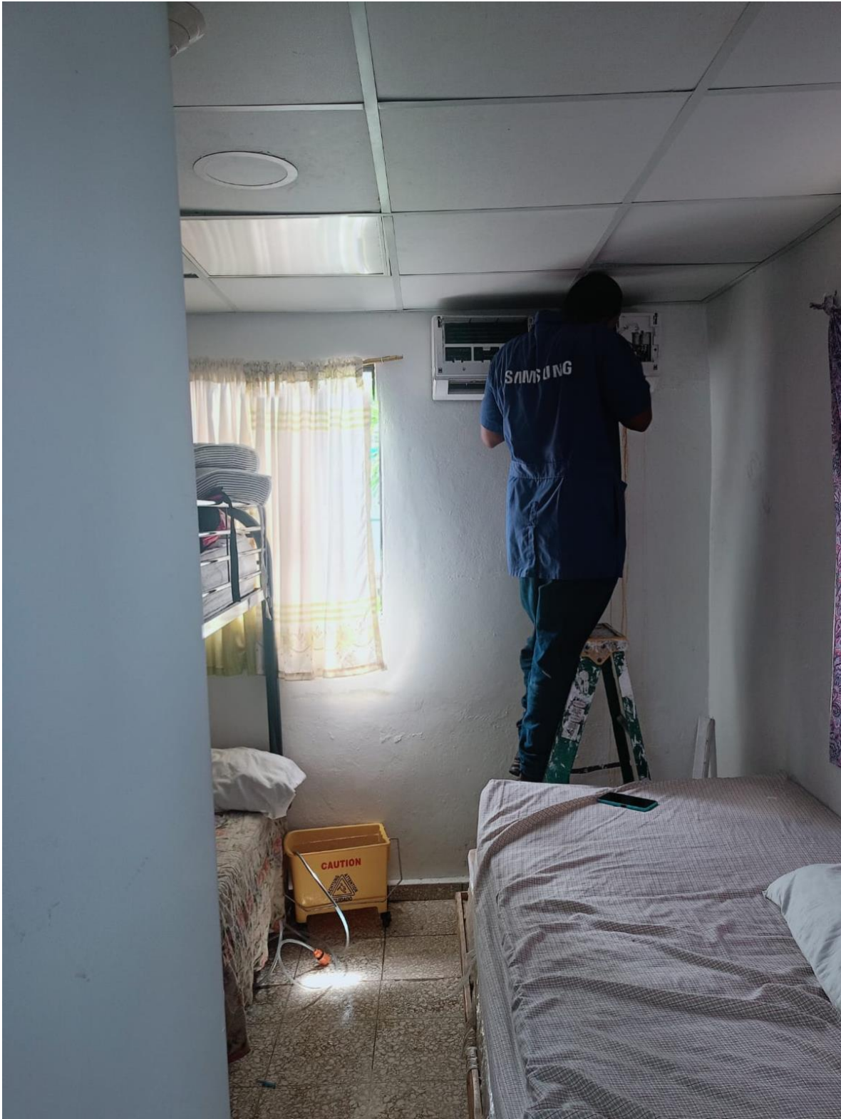
#3. Mantenimiento de filtros de Aires Acondicionados. Almirante Enero 2025
